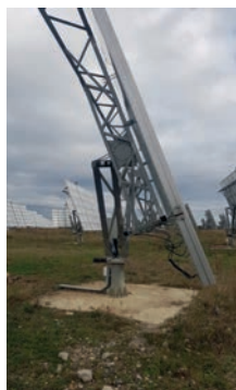
Photo 31 : Double-tracker mono-pieu sur dalle de béton (© Idele)
